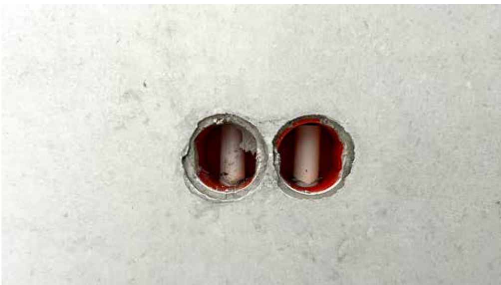
Puszki elektryczne zatopione w ścianie
